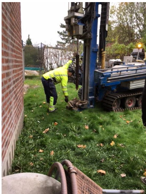
Figur 5. Foto från den miljötekniska markundersökningen vilket visar provtagningspunkt 16ÅF05. Foto: ÅF Infrastructure AB
